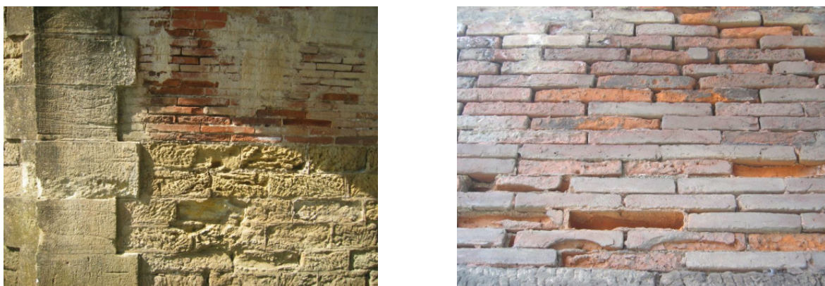
Figure 35 - Altération des briques, des pierres de taille et des moellons. Photos N.D.
