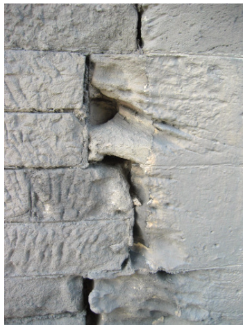
Figure 36 - Décollement entre le chaînage en pierre de taille et les moellons. Photos N. D.
